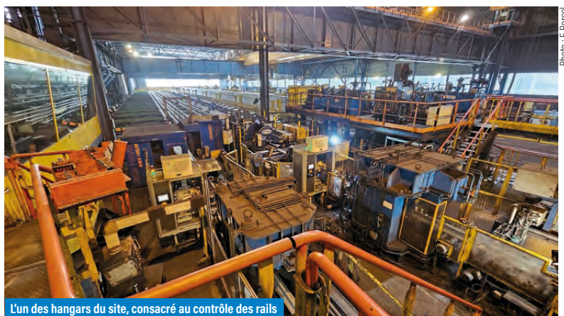
L'un des hangars du site, consacré au contrôle des rails
